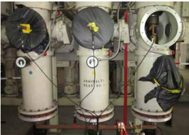
➤ Termination: Ang M. K. 66 kV Substation, SF 6
